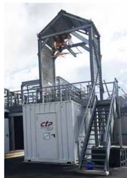
RE-Source by CTP environnement group : pilote de traitement des eaux usées avant réutilisation.
