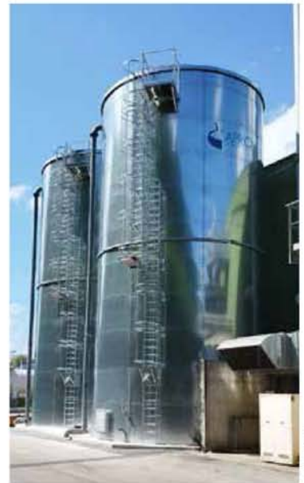
Réservoirs Apro Industrie stockant des eaux de REUSE.
