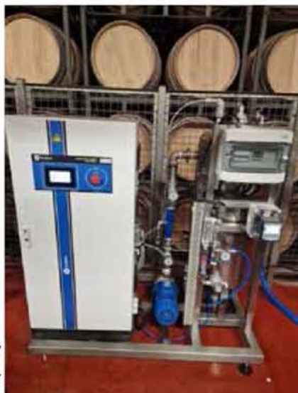
Installation d'un générateur d'ozone pour la distribution d'eau ozonée destinée à la désinfection des cuves, barriques, et pressoir dans une cave vinicole.
